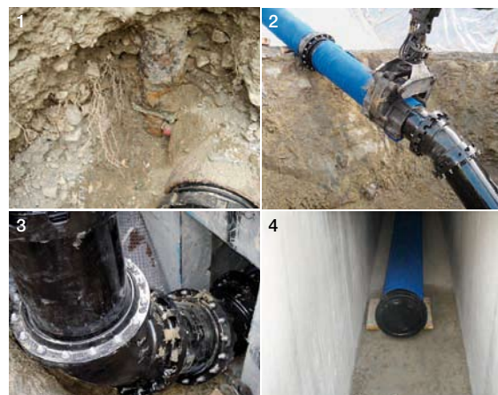
1 Terrain rocheux. 2 Dénivelés extrêmes. 3 Introduction dans le canal en béton. 4 La conduite dans le canal.
