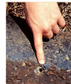
Perforación típica de una canalización con insuficiente protección contra las corrientes de dispersión.
